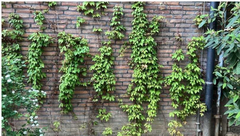
Grünfassade – einjährig an der Gemeinschaftsgrundschule Bingener Weg, Bingener Weg 10 (Foto: Roßkamp)
