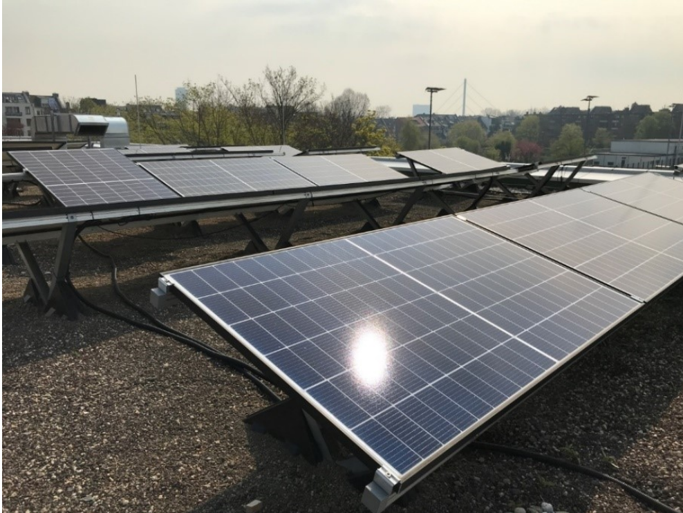
PV-Anlage auf der Carl-Benz-Realschule, Lewitstraße 2, Baujahr 2021, Leistung: 37,63 kWp (Foto: Halbe)
