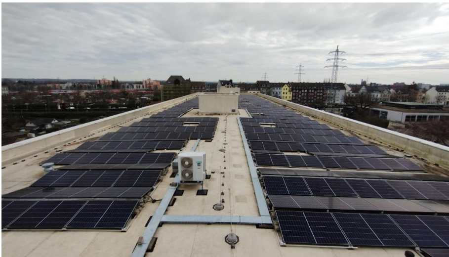
PV-Anlage auf dem Elly-Heuss-Knapp Berufskolleg, Siegburger Str.139, Errichtet 2023, Leistung: 212 kWp inkl. Batteriespeicher (Foto: Schröder)
