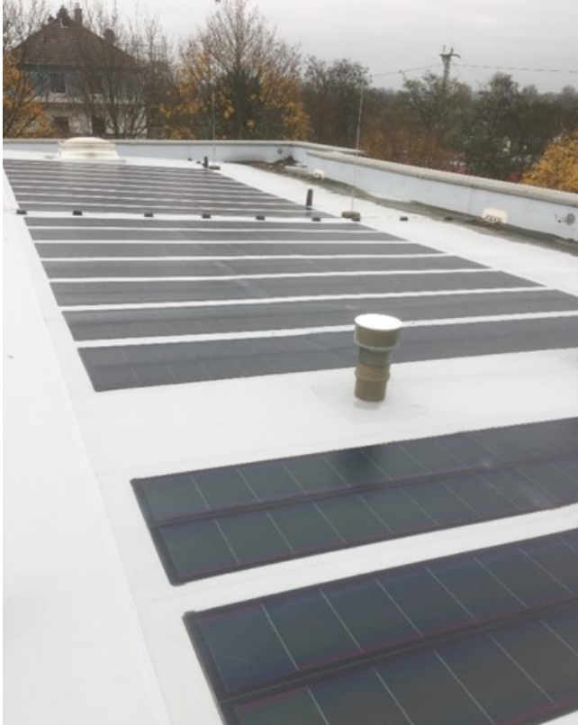
Folien-PV-Anlage auf der Benzenberg-Realschule, Siegburger Straße 38, Baujahr 2004, Leistung: 9,2 kWp (Foto: Halbe)
